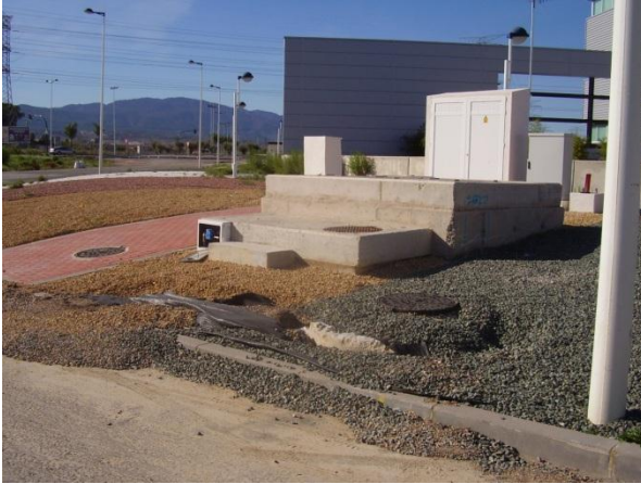
Fotografía 1. EBAR del Centro Integral del Transporte de Murcia.
